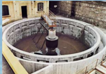
C.Q.S. - Riv. interno depuratore
